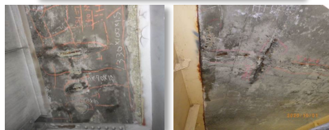
橋梁床版下面の損傷事例
